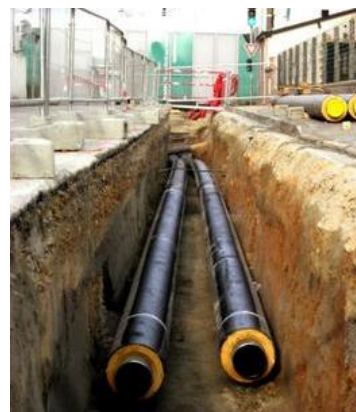
Canalisations de réseau de chaleur
