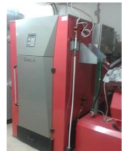
Chaudière de Dozulé
