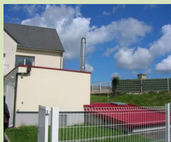
Chaufferie Bois de Dozulé Photo : SDEC ENERGIE
